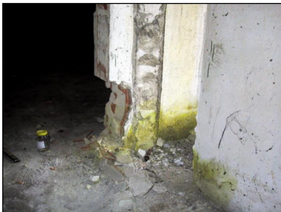
Obr. 5: Zdivo bývalé chromovny s patrnou kontaminací solemi \text{Cr}^{6+}
