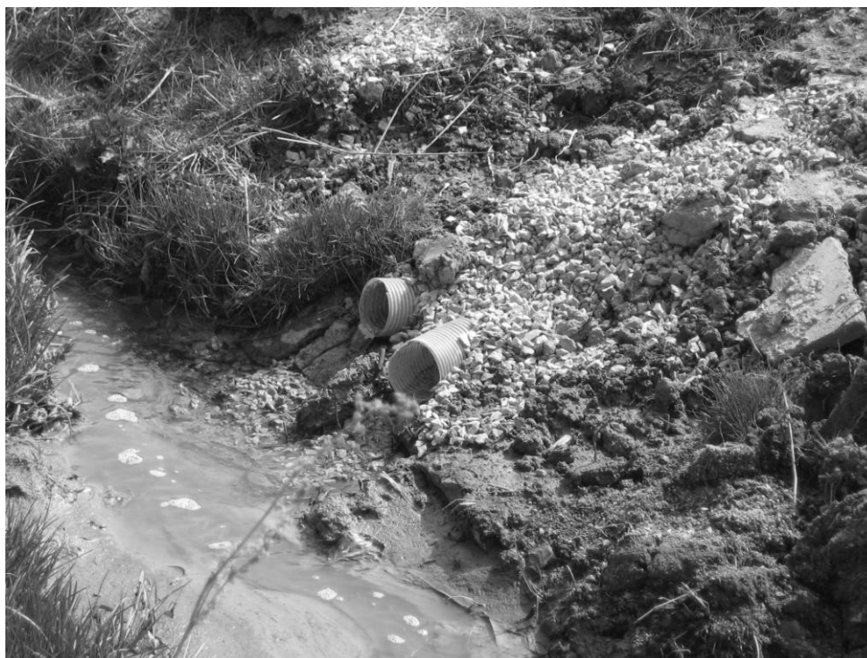
Obr. 1 – Příklad vyústění drenáže pod kanalizací do potoka, obec Hluboké (býv. okres Třebíč)
